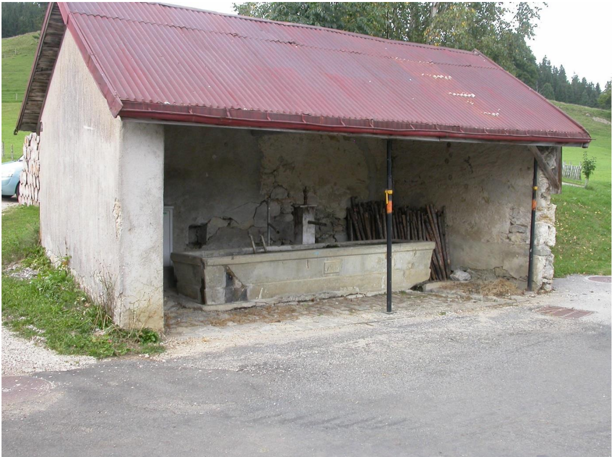
Fontaine couverte aux Piguet-Dessus. L'étau marque l'état de vétusté de la charpente.
