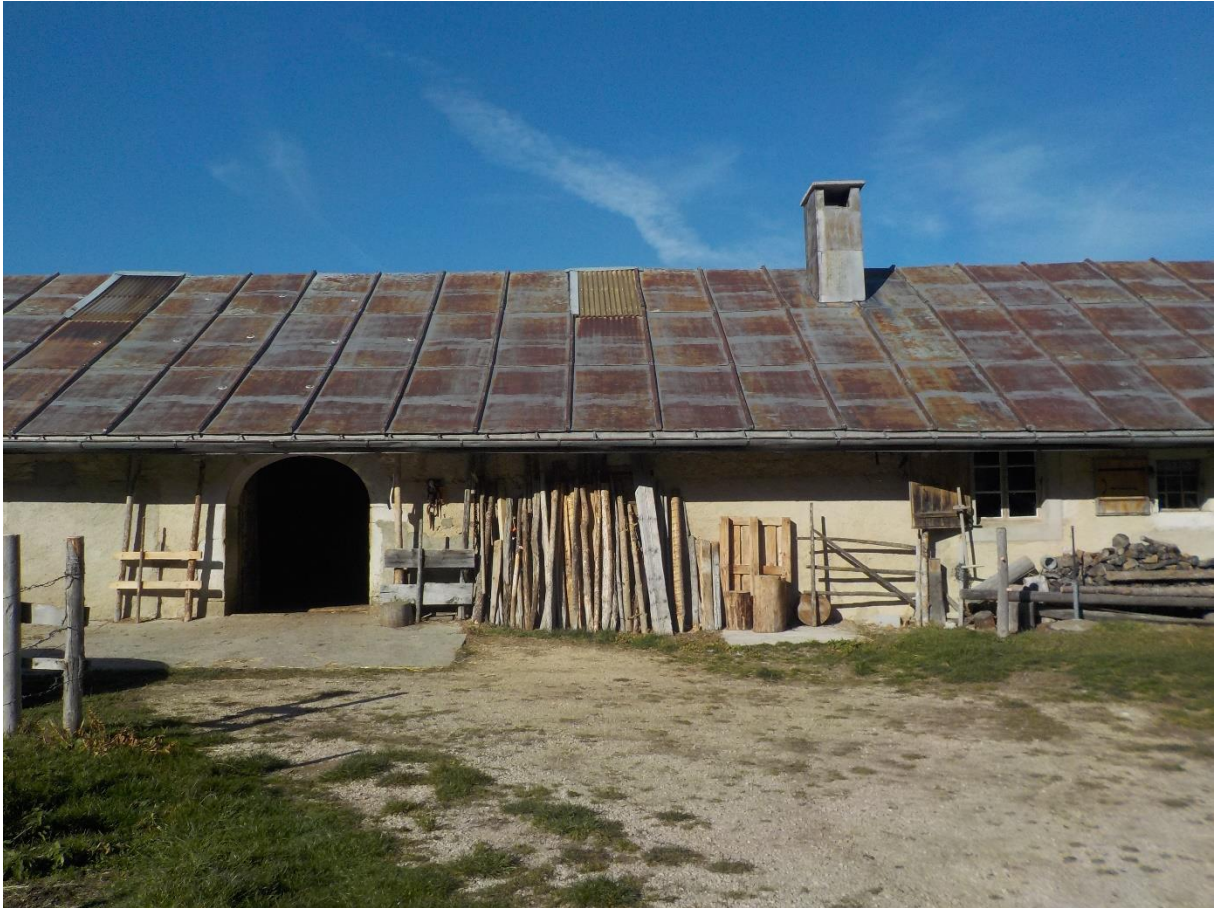
La Branette, chalet de 1809. La citerne est tout de même de beaucoup plus récente, l'une des dernières de la Vallée sans doute à avoir été construite sous la forme que l'on a pu découvrir ci-dessus.
