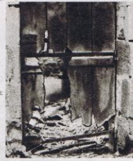
Ce qui reste de la porte de la grange Laudy-Monnier, où de nombreux hommes étaient enfermés. Ils y furent mitraillés à bout portant, puis les SS mirent le feu à la grange. Dans la fumée et les flammes, cinq hommes gravement blessés parvinrent, en un effort surhumain, à se glisser hors du brasier par le trou que l'on voit dans la porte. Ils peuvent témoigner maintenant des horreurs qu'ils ont vues et souffertes.
